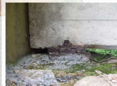
支承部の損傷
