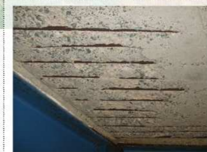
床版の剥離、鉄筋露出
