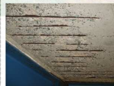
床版の剥離、鉄筋露出
