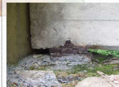
支承部の損傷
