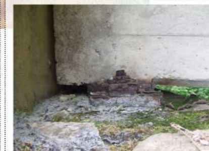
支承部の損傷
