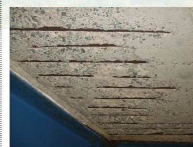
床版の剥離、鉄筋露出
