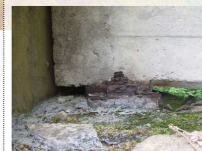
支承部の損傷
