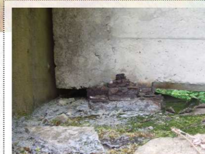
支承部の損傷
