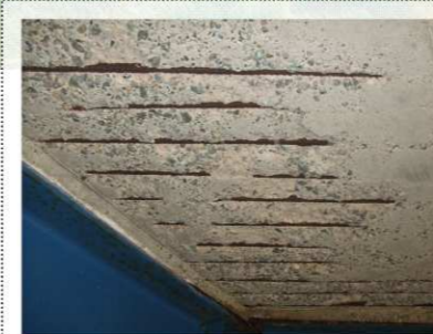
床版の剥離、鉄筋露出
