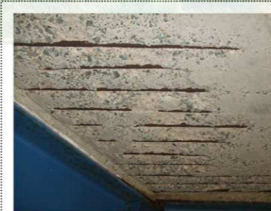
床版の剥離、鉄筋露出
