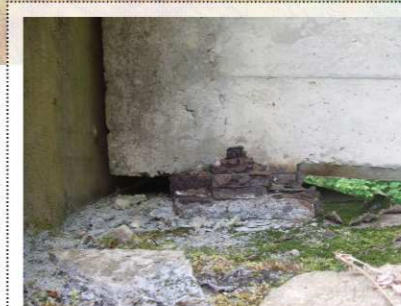
支承部の損傷
