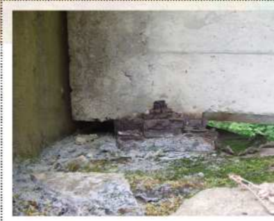
支承部の損傷
