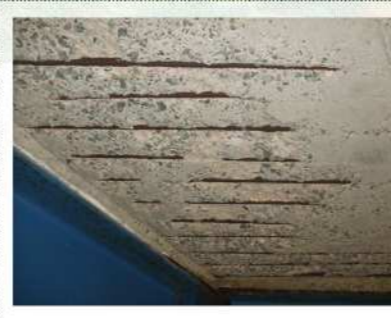
床版の剥離、鉄筋露出
